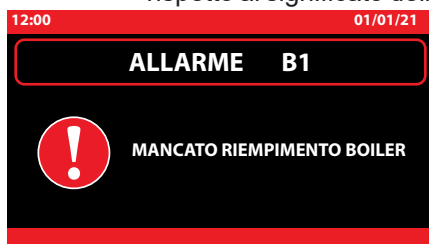
Esempio finestra di allarme.
